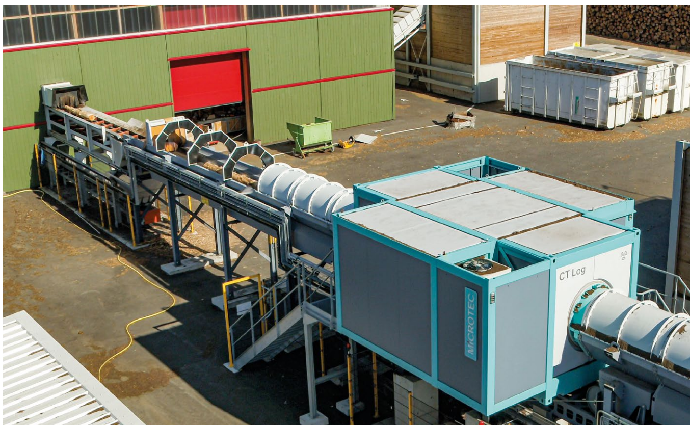
Le scanner à rayons X de Microtec acquis par PIVETEAUBOIS permet d'observer les singularités du bois à l'intérieur de la grume pour optimiser son sciage | © PIVETEAUBOIS
