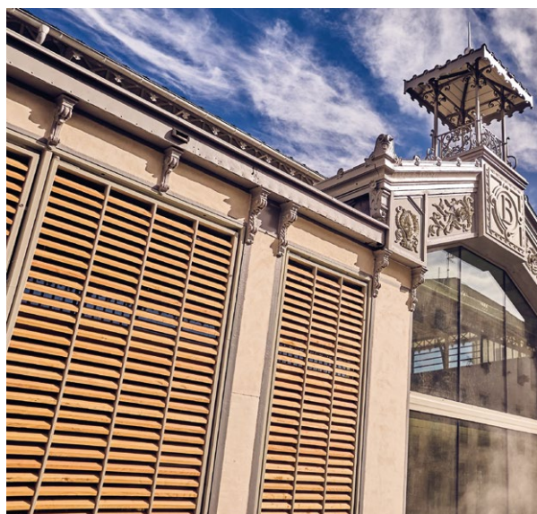
© Ville de Béziers- Chantier des Halles, Architecte NAOS, Maîtrise d'ouvrage Groupe Chevreul
