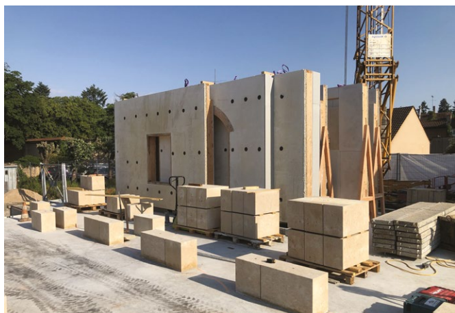
Le chantier du Cèdre à Pary-le-Monial (Herrgott-Farabosc), déroulant de bout en bout.
